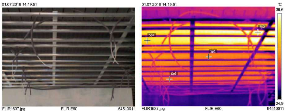
Рис. 1 - Пример проверки с помощью термографической камеры перед установкой потолочных панелей
